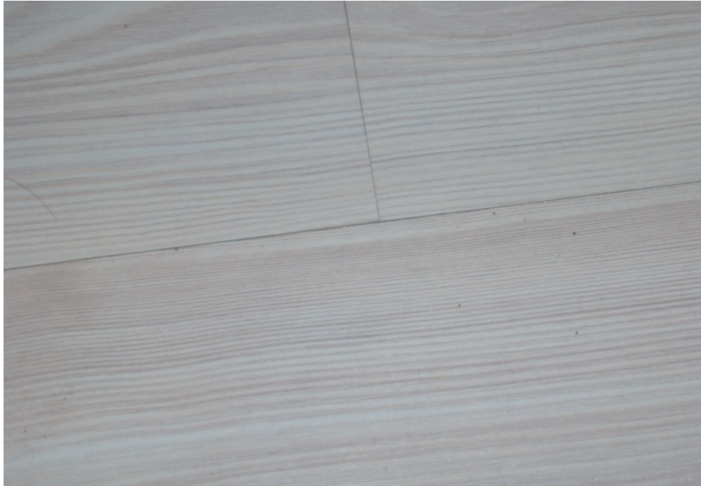
Obr. 7: Zničená plovoucí podlaha (zdroj: vlastní fotografie)
