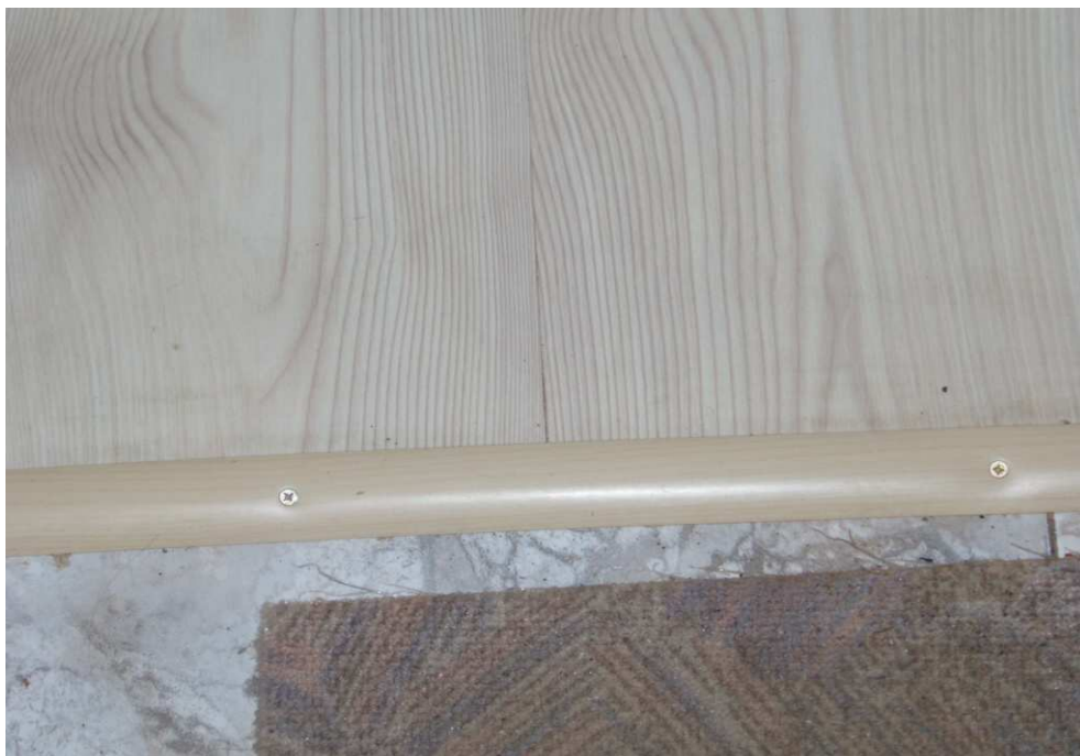
Obr. 6: Zničená přechodová lišta a plovoucí podlaha (zdroj: vlastní fotografie)
