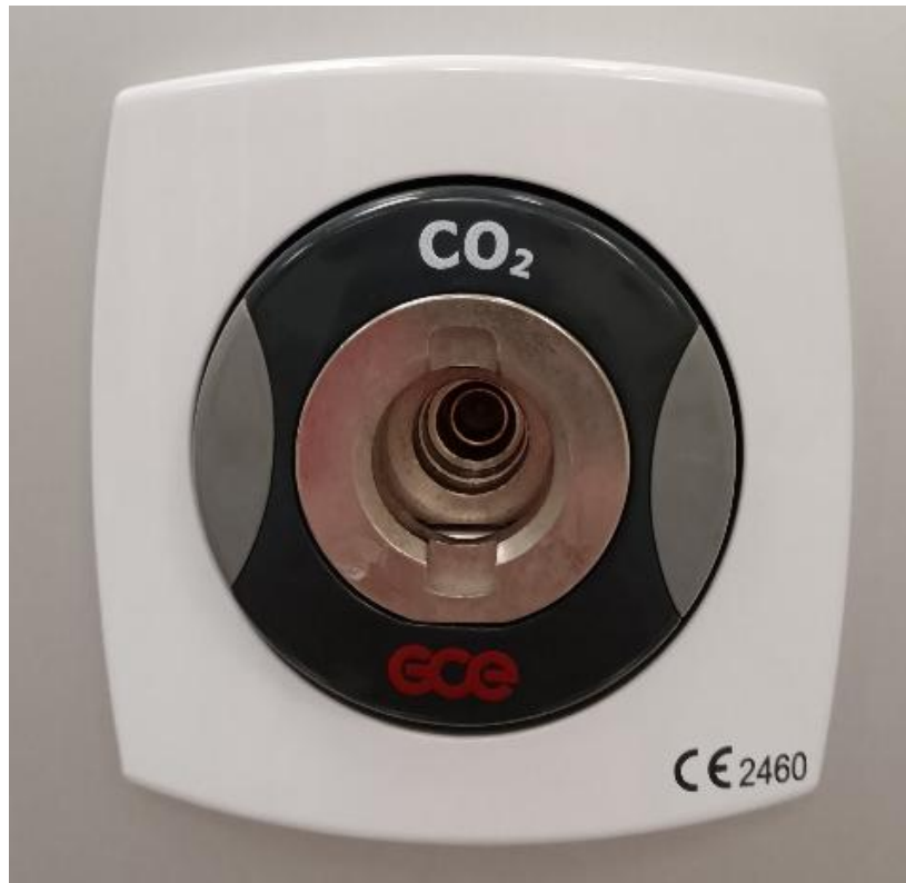
Obrázek 1 - Centrální rozvod plynu (Vlastní zdroj, 2026)
