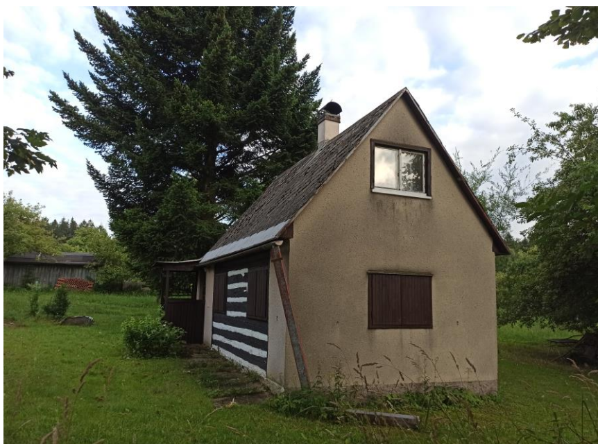
Obrázek 8 - Chata před rekonstrukcí (zdroj: vlastní fotodokumentace)
